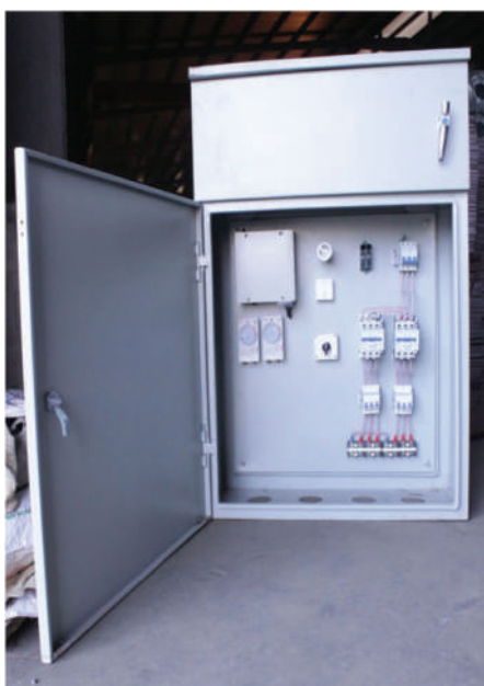
Tủ điện chiếu sáng
